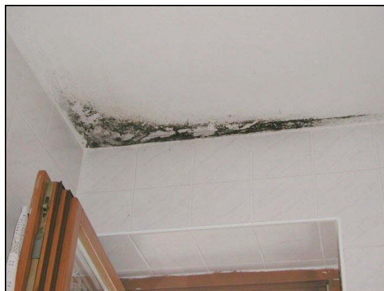
Abbildung 5: Schimmel im Bereich eines Geschoßdeckenanschlusses
